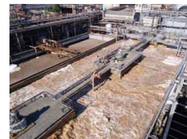
生物処理設備(活性汚泥処理)
